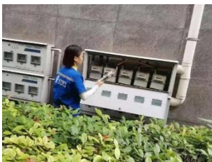
老旧小区安全隐患排查
